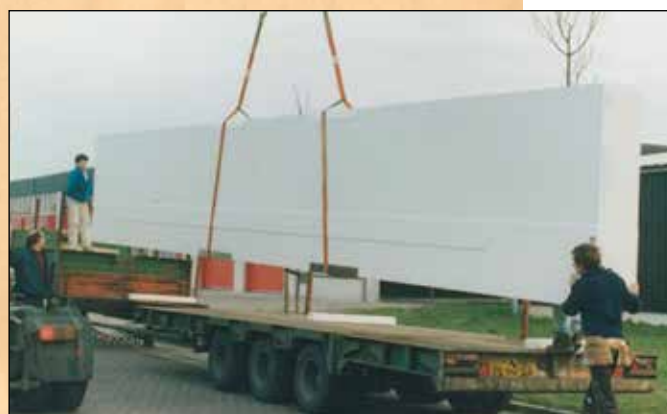
Aposta sobre transporte de uma viga de 12 m de longo por 1,60 m de parte superior em 0,50 m de largo, de cerca de 10 m 3 et de um peso inferior à 500 Kg!
